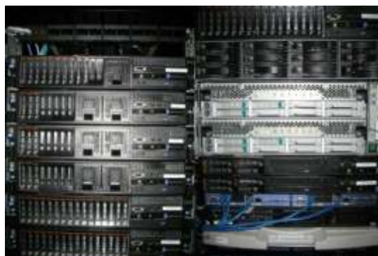
図 2 データセンターに導入されたサーバ群
