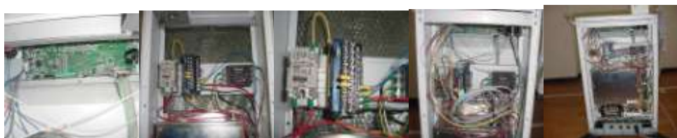
配線 1 配線 2 配線 3 配線 4 筐体内全景
