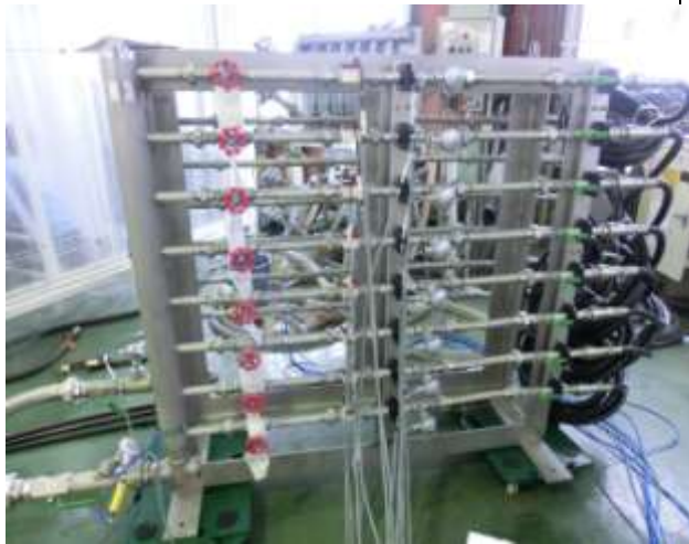
ターゲット冷却システム：一次冷却制御装置本体
